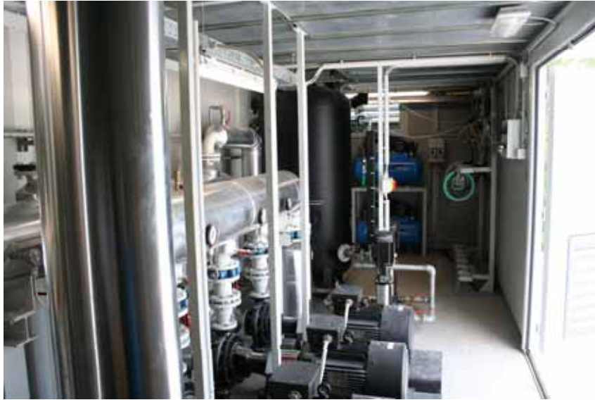
Centrale termica per distribuzione acqua calda
