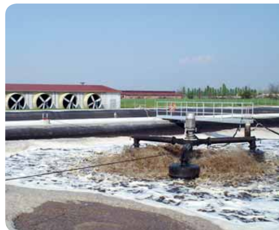
Foto 3 - Immagine di un impianto di trattamento di nitro-denitrificazione con evaporazione realizzato dalla ditta Eukrasia in un allevamento di vitelli a carne bianca
